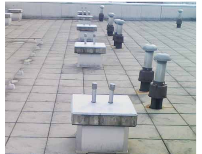
ソーラーパネル用基盤が設置済みの屋上
