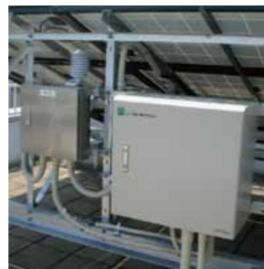
接続箱とパワーコンディショナー(電流変換器)
