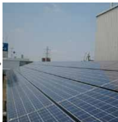
太陽光パネル(56枚)設置後
