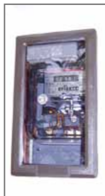
売電メーター
